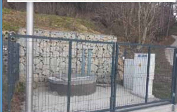
Przepompownia ścieków w Jazowsku
