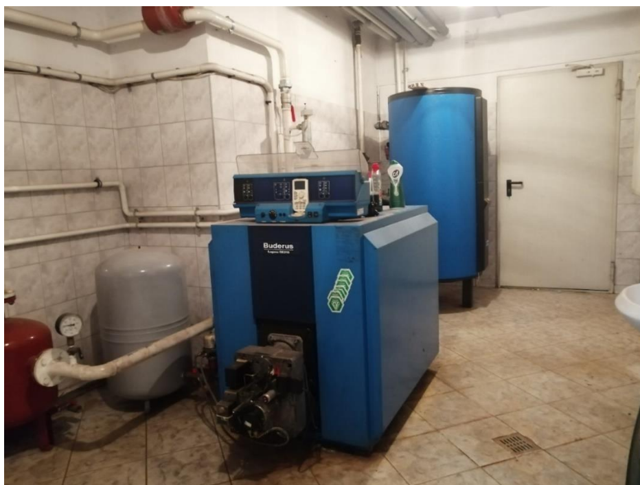
Modernizowana kotłownia w Szkole Podstawowej w Zabrzeży
