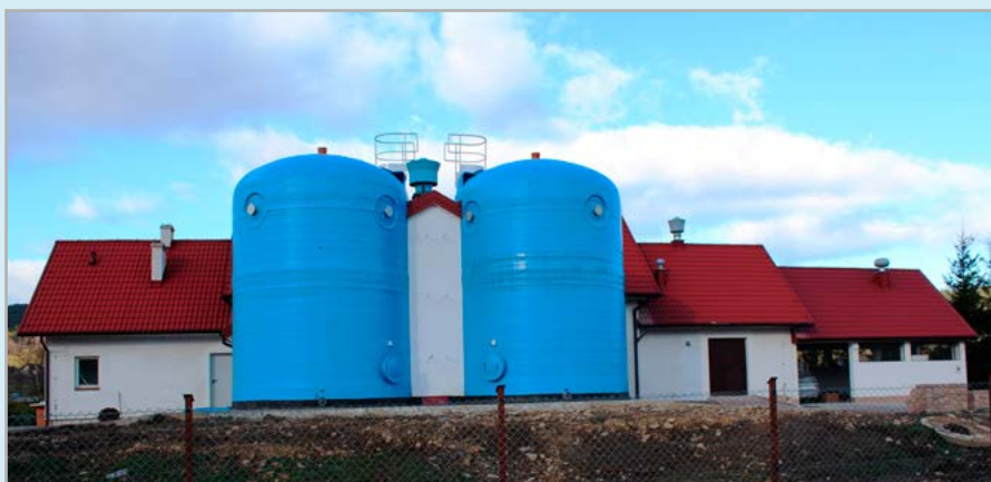
Oczyszczalnia ścieków w Jazowsku
