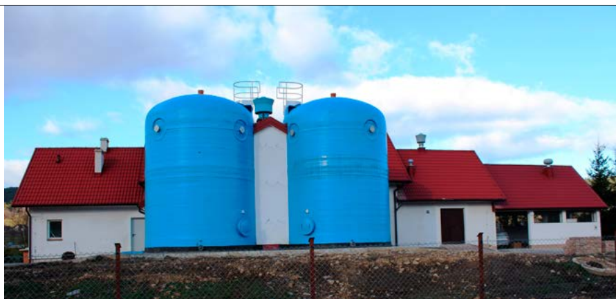
Oczyszczalnia ścieków w Jazowsku
